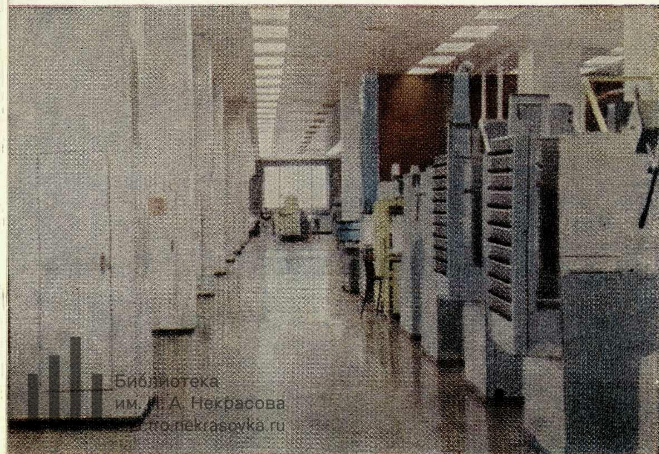
Общий вид реконструированного цеха. Часть коммуникаций проложена в полу, колоннах и подвесным потолком. Легкий доступ к ним облегчает эксплуатацию.
